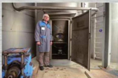
Un silo doté d'une enveloppe, qui limite l'accessibilité au fond vibrant
