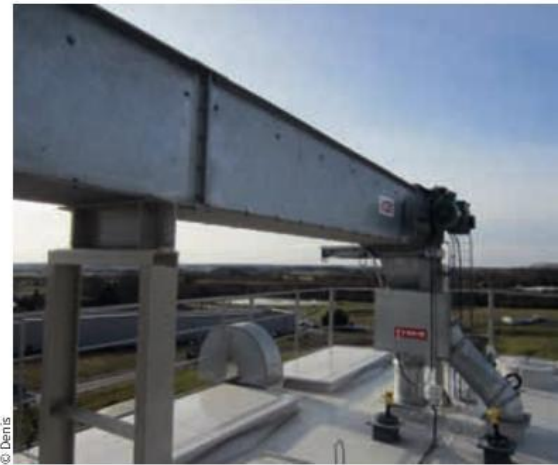
→ Transporteur à chaînes en partie haute.
